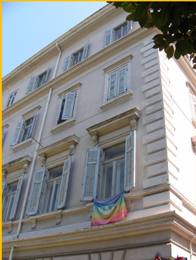
Parte del prospetto nord prima dei lavori di restauro.
